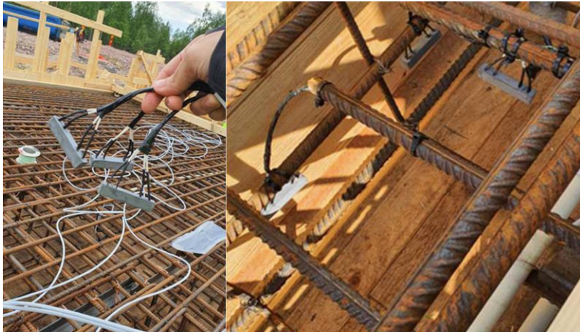
Figur 5. Installation av sensorer på bro nära Pajala i norra Sverige
